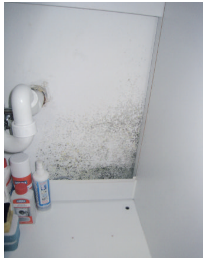
Dieses Foto zeigt nur einen Teil des Schimmelpilzfeldes. Erst nach Abbau der Küchenmöbel wurde die große Fläche des schwarzen Wandschimmels sichtbar. Gerade verdeckte Bereiche sollte man von Zeit zu Zeit überprüfen und schon bei ersten Stockflecken der Ursache auf den Grund gehen – das verhindert größere Schäden. Foto: Dornburg
